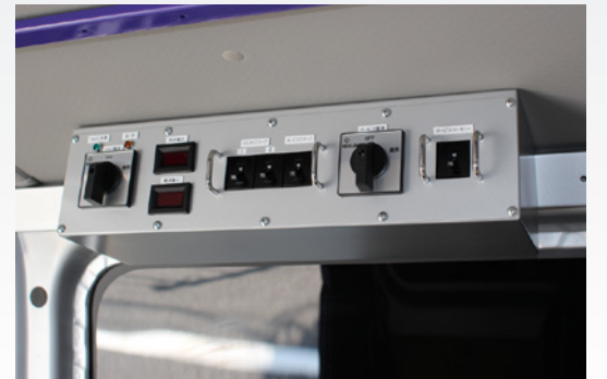
車内に装備された電源パネル
